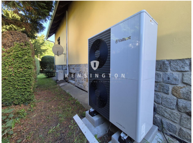
Wärmepumpe und Klimaaggregat
